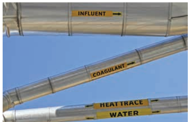
Marquage de tuyaux dans les environnements industriels
