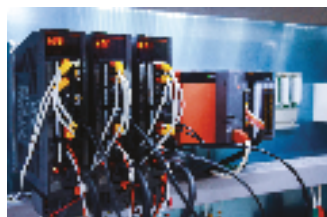
PLC (controllore logico programmabile)
