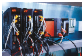
PLC (controlador lógico programable)
