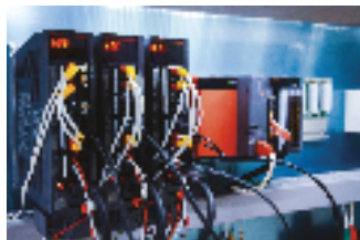
PLC (controllore logico programmabile)
